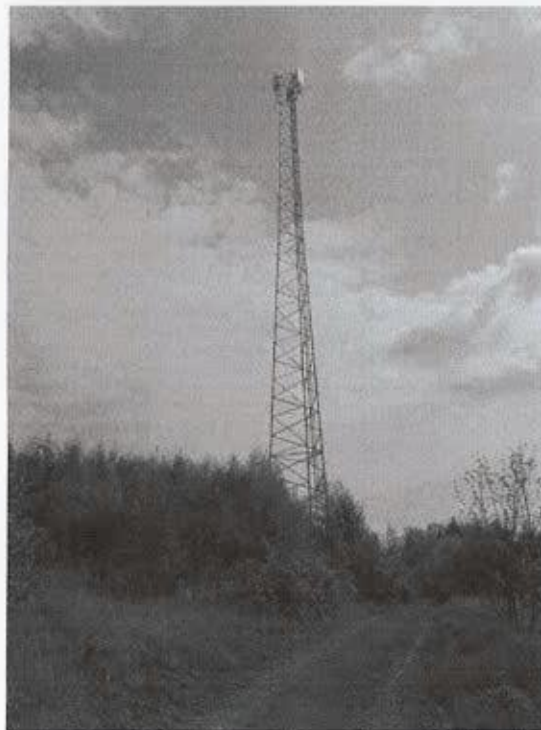
Zał. nr 1: Widok ogólny instalacji radiokomunikacyjnej.
